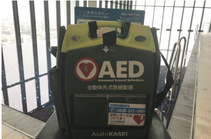
防災センターと32階プールにはAED（自動体外式除細動器）を設置しています。
