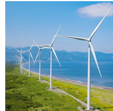
リエネ銭函風力発電所 (風力発電所)
